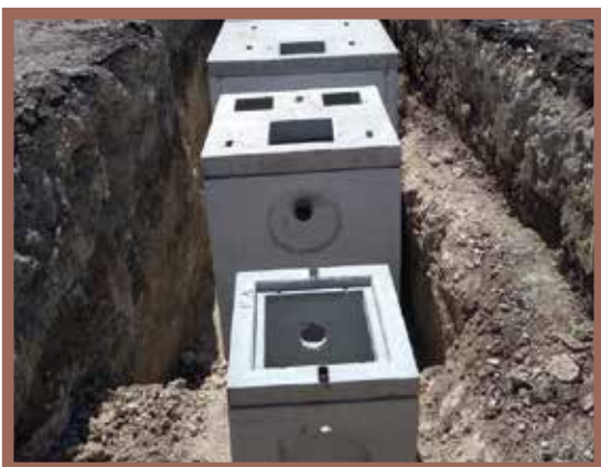
IMPIANTI TRATTAMENTO ACQUE METEORICHE IN CEMENTO
