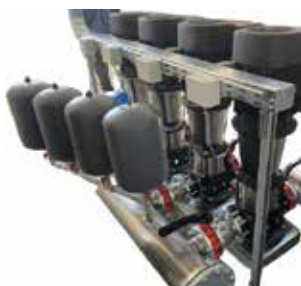
GRUPPO DI PRESSURIZZAZIONE
