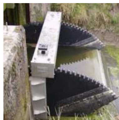
Paratoia basculante o a ventola
