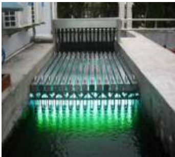
Sistema di disinfezione a raggi Uv
