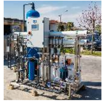
Impianto osmosi inversa su skid
