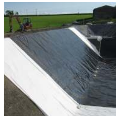
Geomembrane HPDE HPDE geomembrane liners
