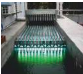
Sistema di disinfezione a raggi Uv
