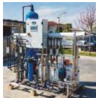
Impianto osmosi inversa su skid
