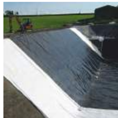
Geomembrane HPDE HPDE geomembrane liners
